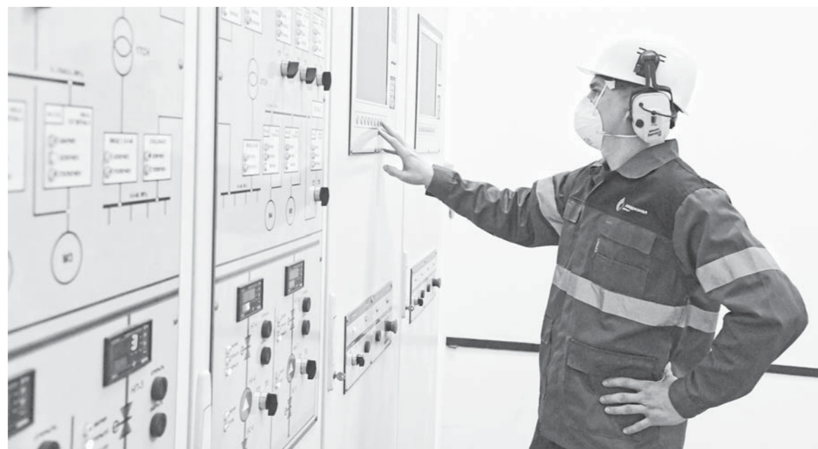
КНС № 21 – современная, полностью автоматизированная станция.
