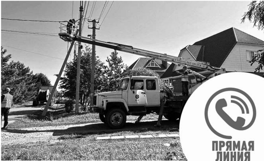
Новые линии наружного освещения актуальны для пригорода Ленинского района.
