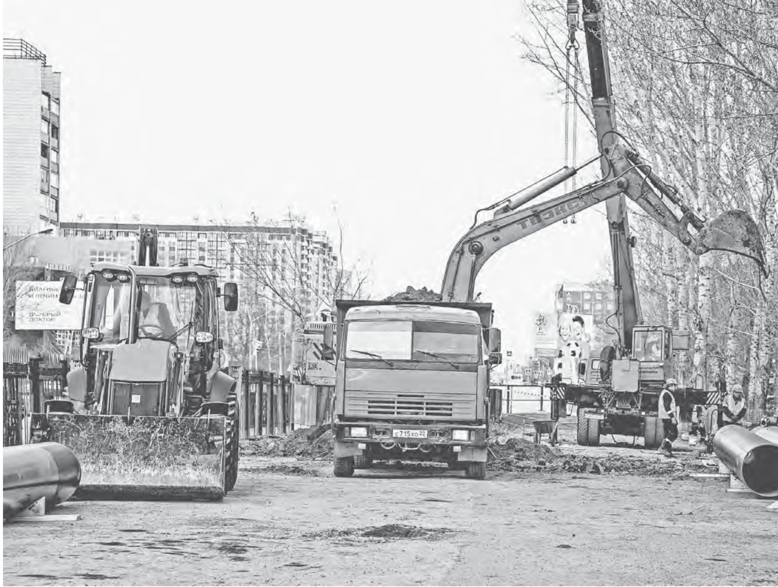
При подготовке к отопительному сезону особое внимание уделяется ремонту сетевого хозяйства Барнаула.
