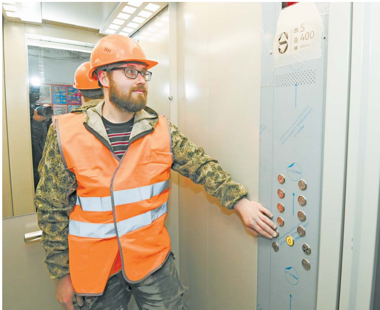
В новой лифтовой кабине еще не сняты защитные пленки. Скоро оборудование запустят в эксплуатацию.
